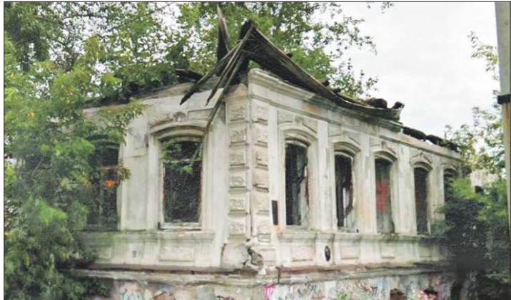
Усадьба купца Алексея Звонарёва по адресу Карла Маркса, 4/Горького, 32 была построена в 1870-е годы. В последнее время она была в крайне плачевном состоянии. Из-за разрушения и пожара от некогда красивого здания остались только стены и фундамент. В 2019 году руины выкупил создатель клиники «Здоровье 365» на торгах за символический рубль (ещё шесть миллионов стоила земля).
