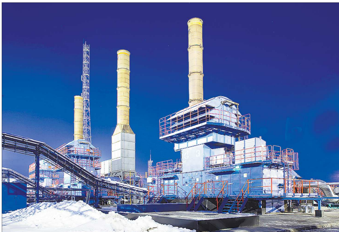
Компрессорная станция магистрального газопровода
