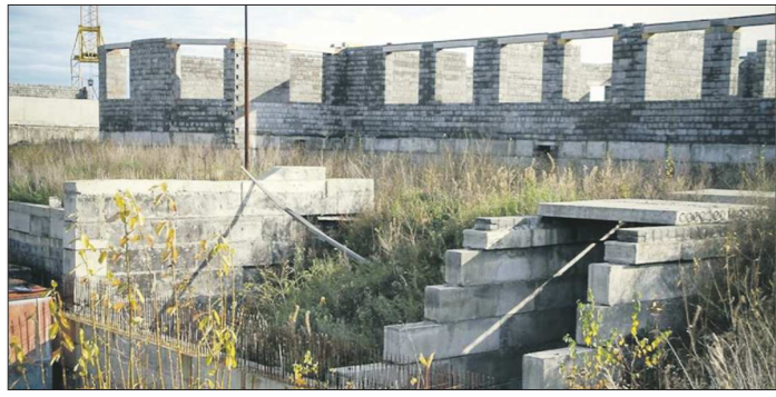
Больничный долгострой неплохо сохранился, и есть надежда, что труд строителей не пропадет даром
